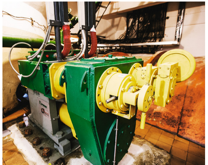
Приводные электроцилиндры направляющего аппарата на Пальеозерской ГЭС
