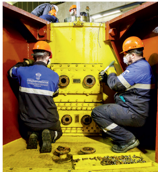
Модернизация Верхне-Туломской ГЭС предполагает полную поэтапную замену гидроагрегатов станции, систем регулирования, защит и автоматики
